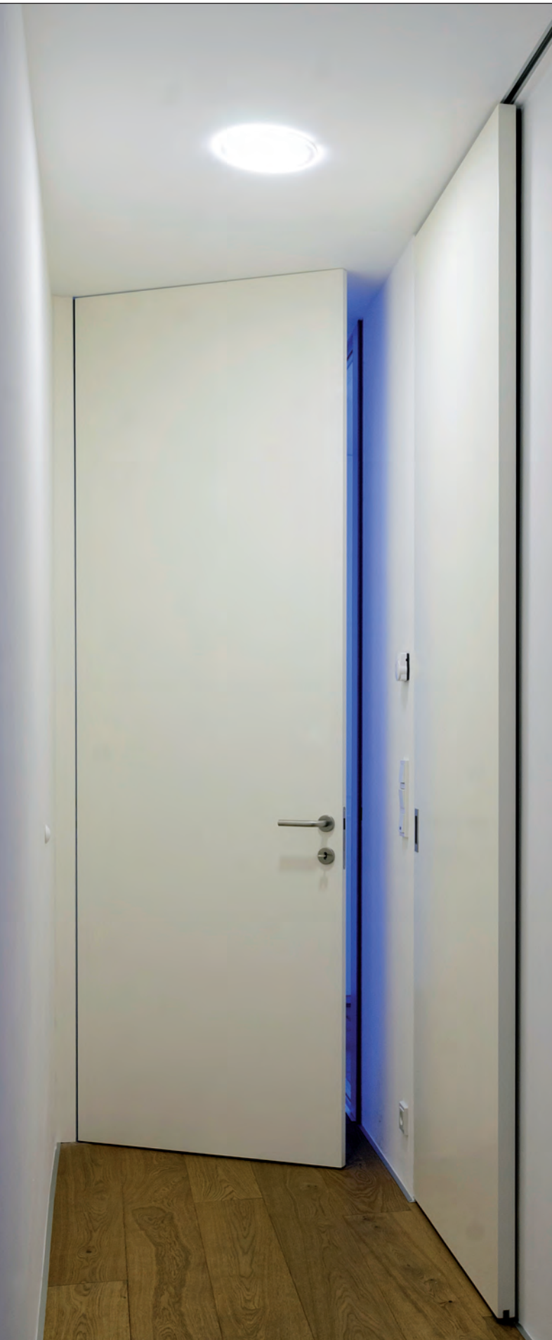
„New Life 000“ | raumhoch weiß deckend lackiert | Schiene der Schiebetür in die Decke integriert
